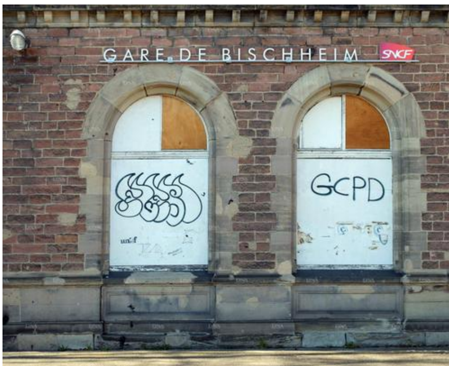
Le bâtiment de la gare se dégrade peu à peu. Photo DNA /DR
