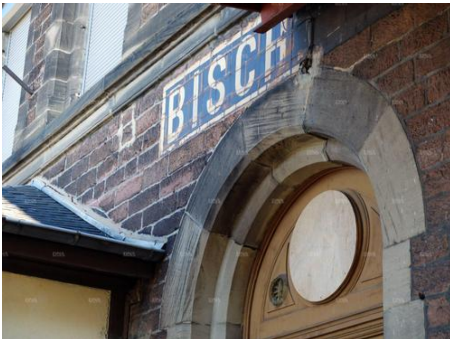
La façade de la gare est en piteux état Photo DNA /DR
