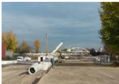
Le lancement du tablier et de la partie de l'arc a été achevé début novembre.
